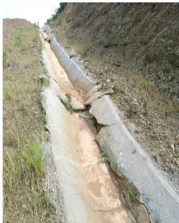
(d) Surface Crack on Slope Drain
